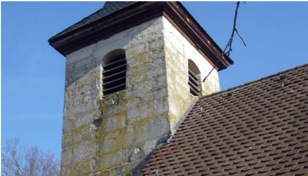
Detail des Turms vor der Restaurierung.
