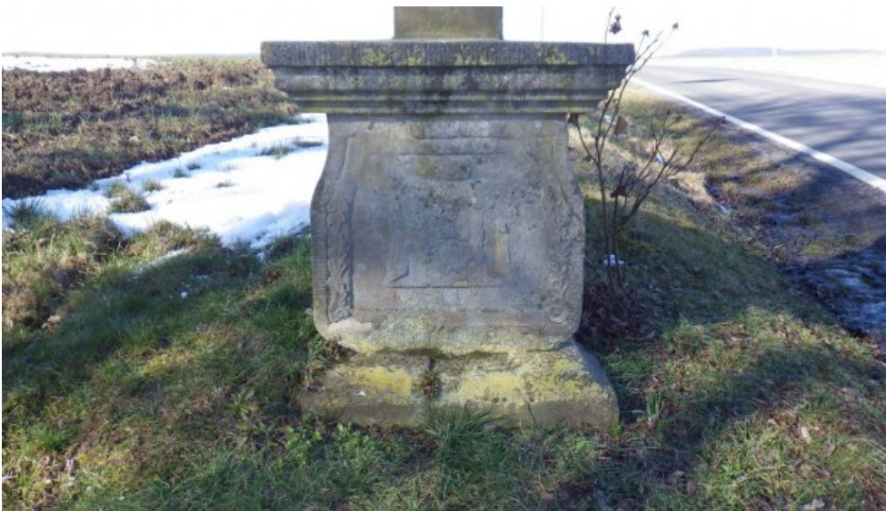
Sockel mit Darstellung 'Schweißstuch der Veronika', vor der Reinigung. Das Relief ist bereits stark zurückgewittert, Fehlstellen erkennbar.
