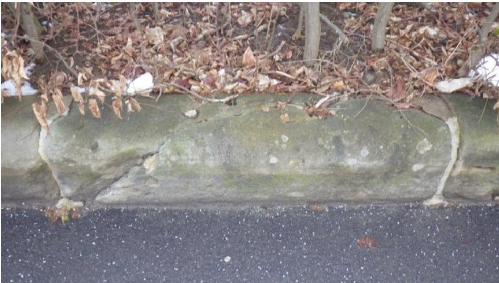
Rissbildung an der Oberseite eines Mauersteins. Über den Riss kann Feuchtigkeit in das Gefüge eintreten.
