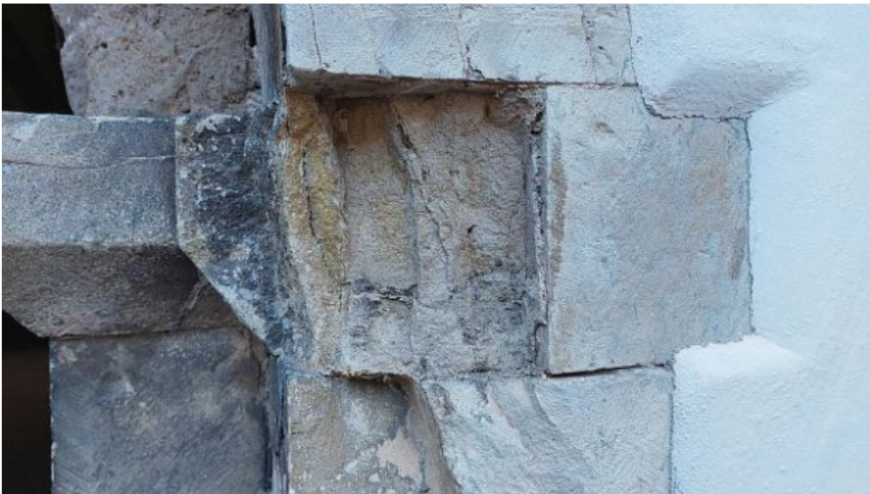
Der Kämpfer war mehrfach gebrochen. Die abgelösten Bruchstücke wurden abgenommen und der Untergrund gereinigt.
