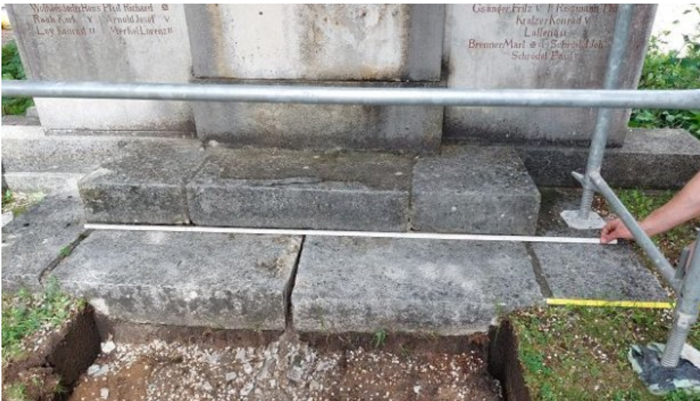
Vor dem Abbau: genaues Aufmessen von Größe und Position der einzelnen Bauteile.
