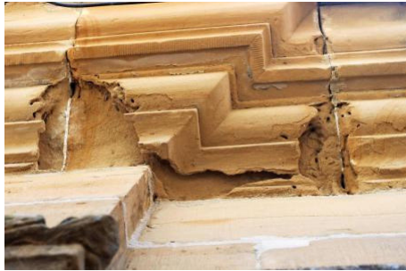
Die Schäden an den Sandsteinen der Filialkirche entstanden durch Wespen und Bienen. Foto: Gerd Klemenz
