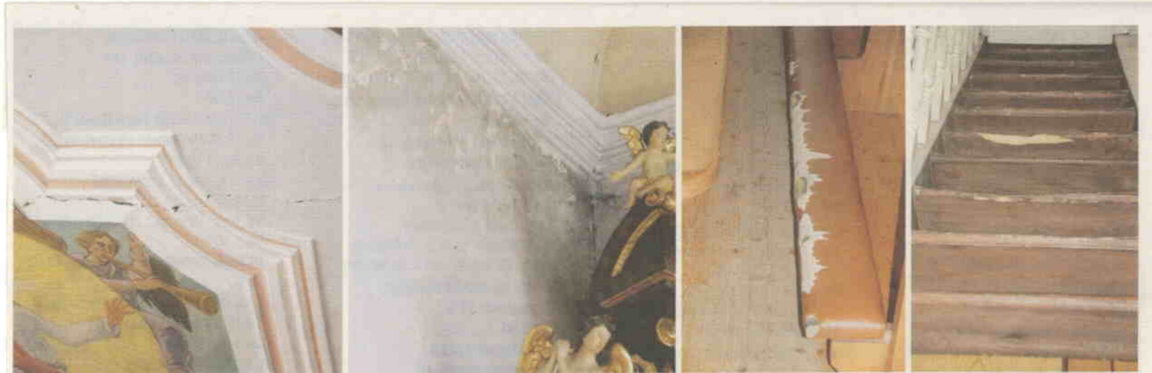
Die Bilder zeigen eine Auswahl der Schäden die fachgerecht beseitigt wurden.
