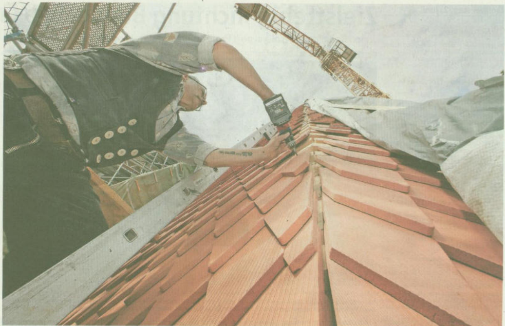
Dachdeckermeister Rudolf Trummer montiert den vorerst letzten Ziegel: Immerhin das neue Dach über dem Chorraum ist schon fertig. Fotos: Michael Matejka
