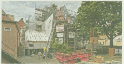
Ohnehin schon versteckt zwischen Königsturm und Peuntgasse gelegen, ist die Kirche ganz eingepackt von den Gerüsten und Planen der Bauhütte.
