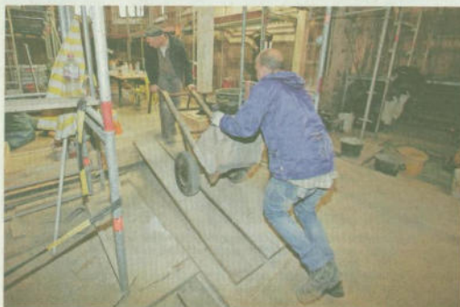
Zwei Mitarbeiter transportieren einen Block aus der Säule ab (siehe Bild links). Das Feuer hat den Stein ganz krümelig werden lassen — er muss ausgetauscht werden. Als Ersatz kommt Sandstein aus dem Steigerwald. Der sieht zwar heller und feinerporiger aus als der Nürnberger, war aber eine Empfehlung des Denkmalschützers.
