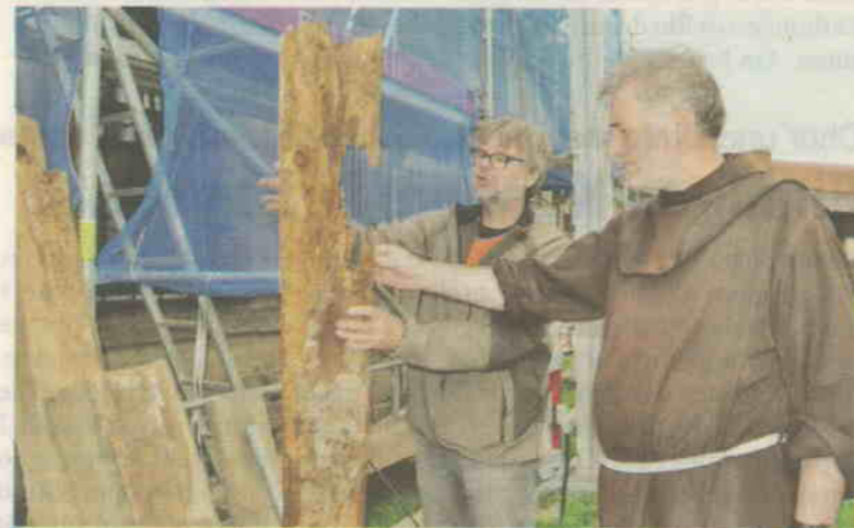
P. Rufus begutachtet einen durchmorschten Balken.
