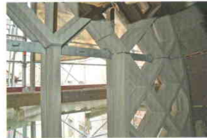
Das Maßwerkfenster an der Orgelepore wurde vom Bamberger Natursteinwerk komplett aus dem Sandstein STEIGERWALD-QUARZIT neu gefertigt und eingebaut. Foto: mbi
