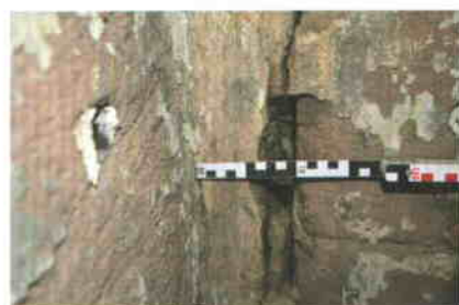
Die teilweise massive Rissbildung machte weitreichende Stabilisierungs- und Sicherungsmaßnahmen erforderlich. Foto: mbi
