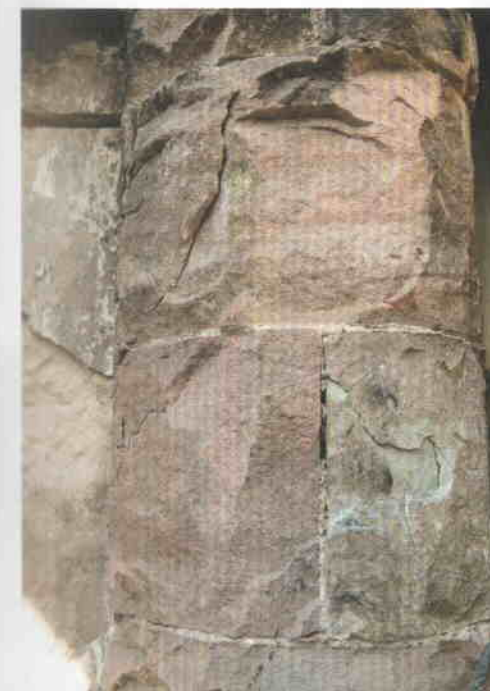
Oben: Durch Hitzeeinwirkung abgeplatzte Steinoberfläche Foto: ProDenkmal
