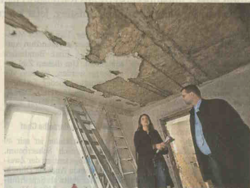
Bauleiterin Silke Leikheim und Stiftungsreferent Bertram Felix stehen unter einer historischen Decke mit Lehmfüllung, die belassen wird.
