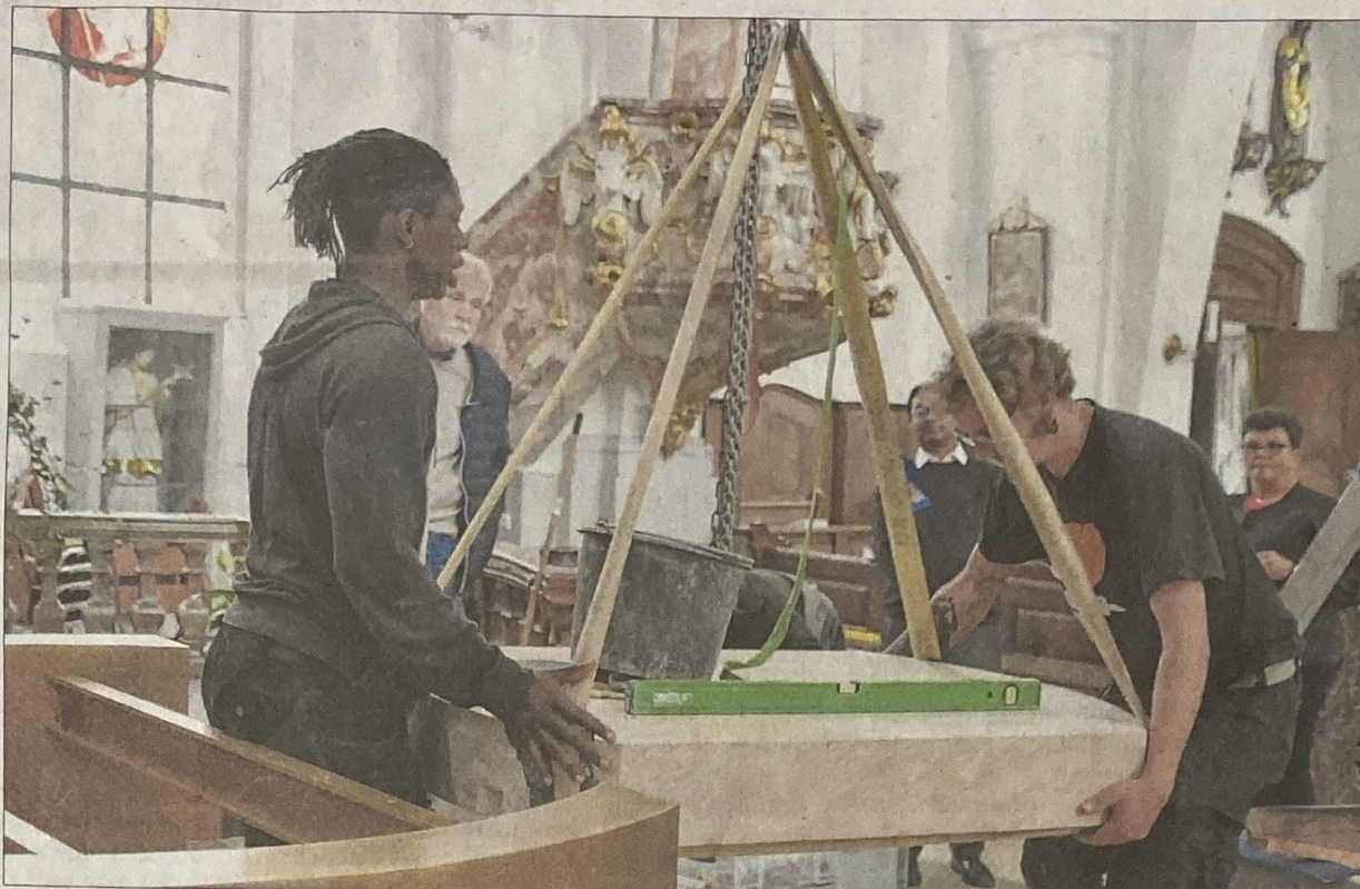
Nelson Mzobe (links) und Christof Peters richten sich die Steinplatte des Altars zurecht, um sie auf ihr Metallgestell zu heben. Im Hintergrund verfolgen – von links – Architekt Herbert van Beek, Stadtpfarrer Joseph Michael und Brigitte Wendinger vom Pfarrgemeinderat aufmerksam jeden Handgriff. Foto: Andreas Reum
