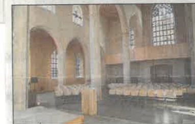
Die enormen Brandschäden und der neue Kircheninnenraum.
