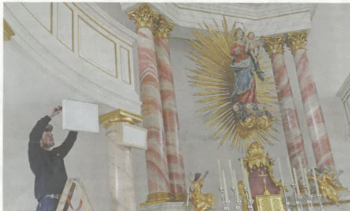
Martin Schäfer von FBG Bayreuth legt die letzten Handgriffe für die neue Lautsprecheranlage an.
